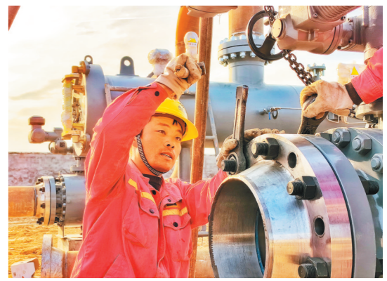
进入3月以来,中铁二十局电气化公司西延铁路油气管道改建工程项目部,积极开展“保安全、提质效、促进度”主题劳动竞赛,确保项目按照工期节点高质量完成。图为工人在洛川天然气分输站安装设备。 通讯员 白小波 摄
