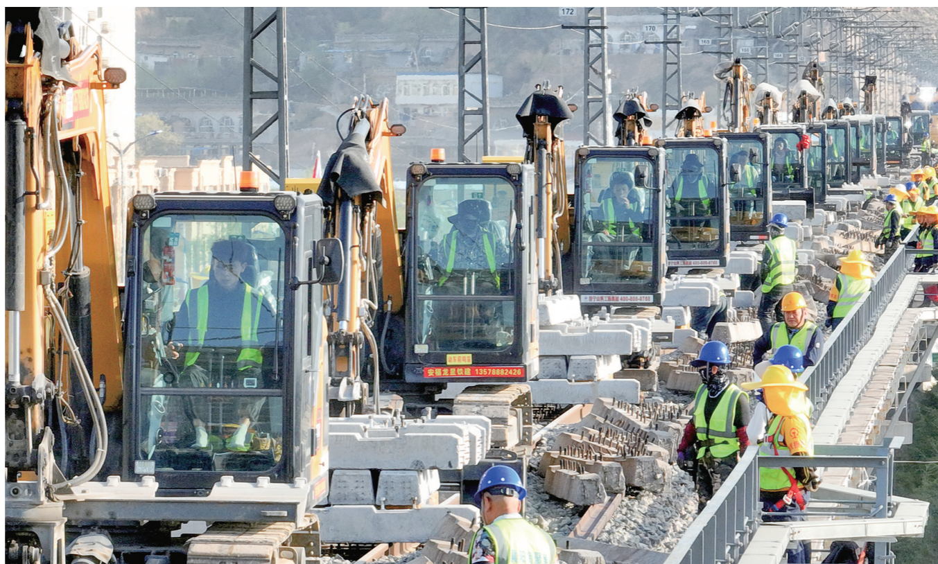
近日,连接关中与陕北地区的能源运输大通道——包西铁路设备集中整修正在如火如荼进行。为高质量推进铁路设备集中整修,国铁西安局延安工务段调集全
