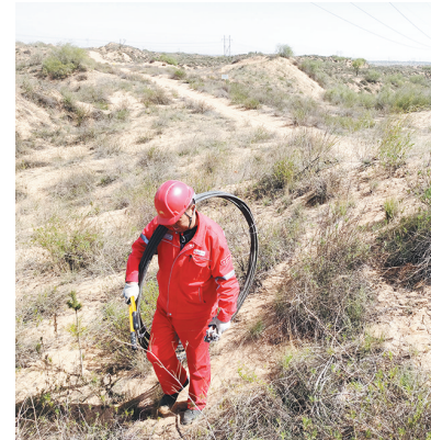
“五一”前夕,长庆油田清洁电力开发项目部靖边电力大队的电力工人对沙漠地区的兰电110kv线路进行检修,保障节日期间原油生产和油田生活用电。 □通讯员 俱伟 摄
