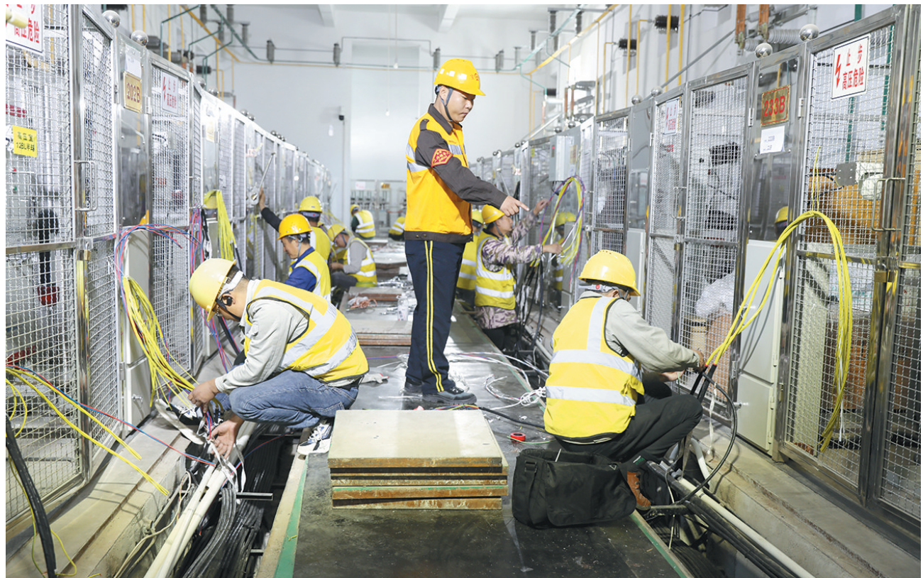
近日,宝成线牵引供电系统的供电“心脏”变电所综合自动化施工改造正如如火如荼进行中。为保证施工期间人员设备安全,西安铁路局宝鸡供
