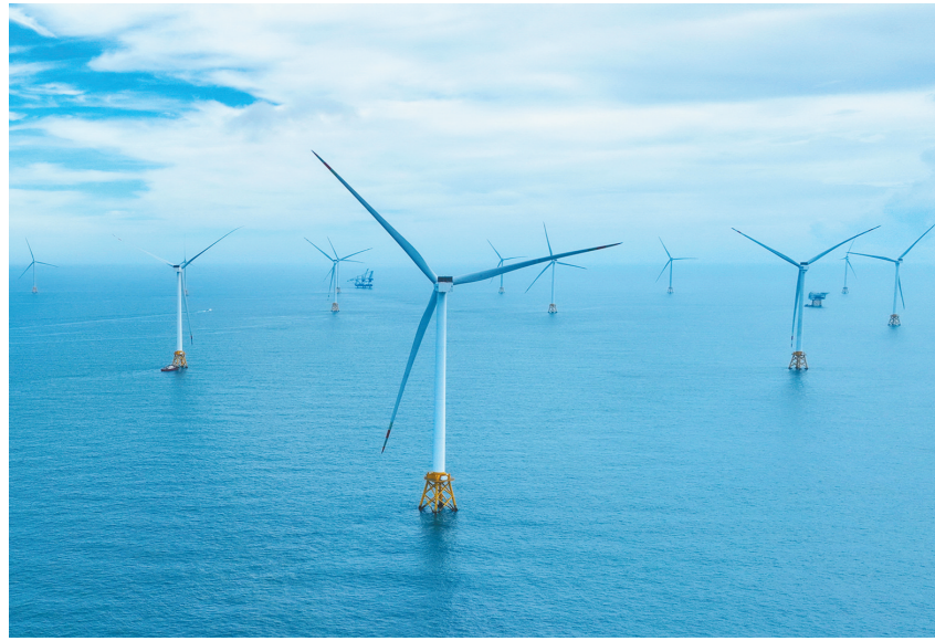
6月27日，全国首个超大单机容量的海上风电机组项目——三峡集团漳浦二期海上风电项目实现全容量并网发电。项目投产后，预计每年可生产16亿度清洁电能。 新华社记者 林善传 摄
