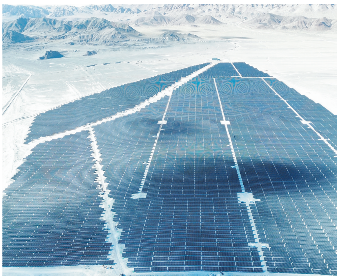
7月29日,由陕建三建集团二公司负责施工的紫金龙滩拉果盐湖提锂“源网荷储”新型能源系统二期二阶段项目顺利并网发电。该项目是专为拉果盐湖区域的锂矿量身打造的光伏供电项目,是西藏地区目前最大的储能电站项目。 □通讯员 管峰 刘祥胜 摄
