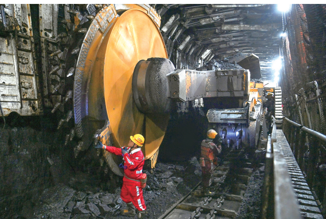
2月29日,工作人员在陕煤曹家滩矿业有限公司10米超大采高智能综采工作面进行检修。(资料图)
