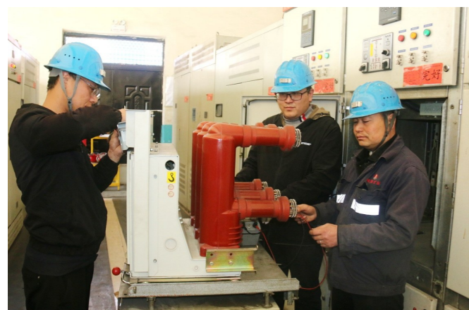
近日,韩城矿业桑树坪二号井开展“春检”工作,为矿井供电系统全面“体检”,消除系统“亚健康”,精心护航全年安全生产。通讯员 焦娟娟 赵国平 摄
