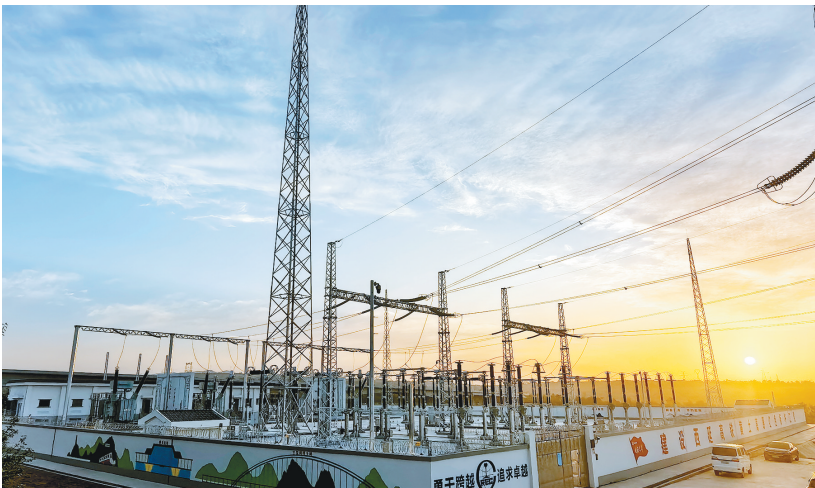
5月23日5时50分，中铁电气化局承建的西延高铁铜延段变电工程王益牵引变电所完成五次带电冲击实验，标志着西延高铁首座电气牵引变电所受电启用。通讯员 于刚 摄
