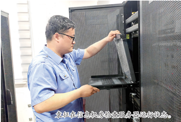
袁征在信息机房检查服务器运行状态。
