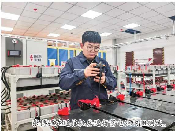
张博强在通信机房进行蓄电池内阻测试。
